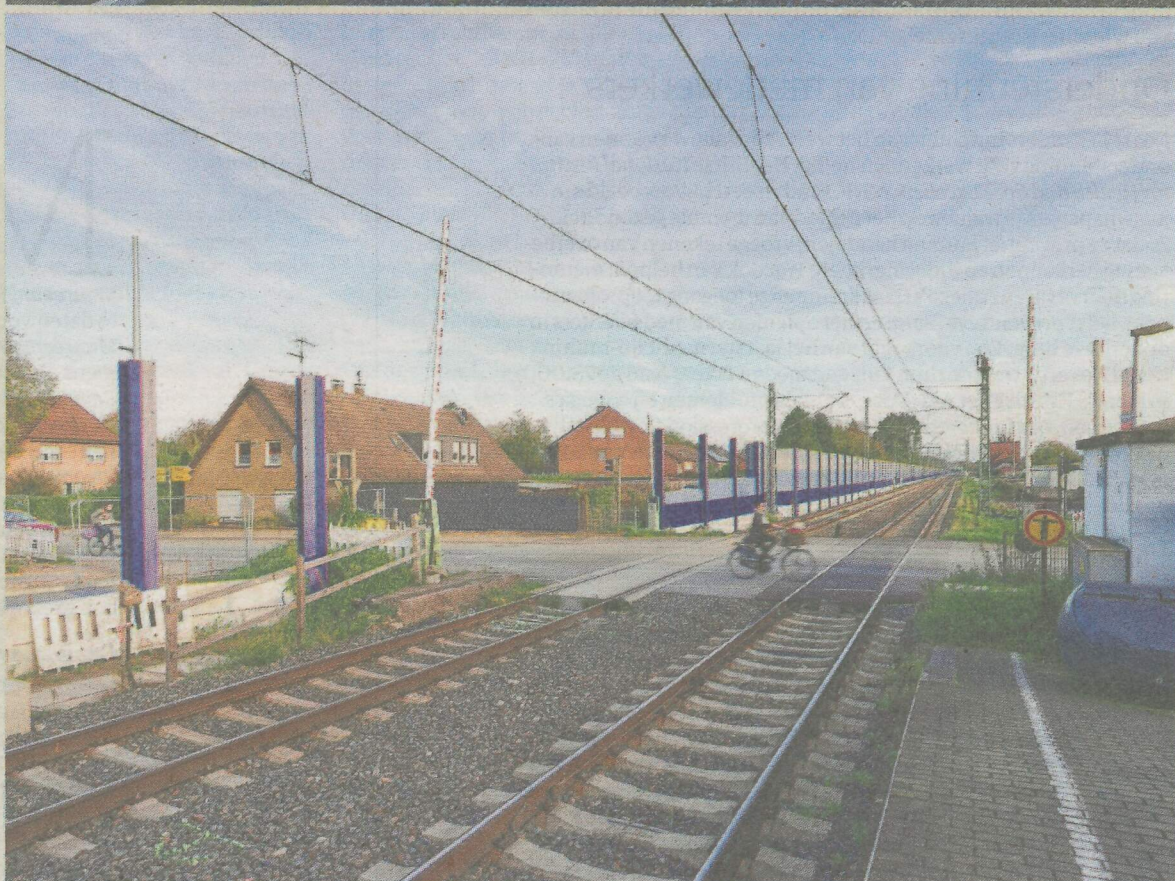
Tussen Oberhausen en Emmerich bouwt de Duitse railbeheerder DB InfraGO aan nieuwe spoorinfrastructuur. Tussen de plaatsen Voerde en Wesel (boven) zijn oude spoorbruggen vervangen, bij Mehrhoog (midden) ligt al een deel van het extra derde spoor, en in Haldern (onder) wordt het station verbouwd.
